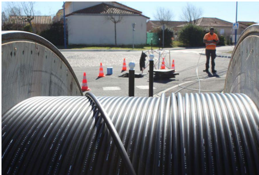
Le déploiement de la fibre optique se poursuit à Aureilhan. Photo : Ville d'Aureilhan
